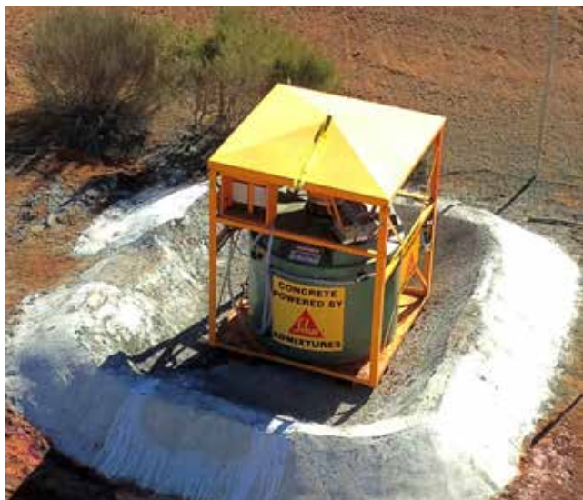
(3) Poste de malaxage sur chantier pour la production de l'accélérateur liquide Sigunit® à partir de la poudre instantanée Sigunit®
