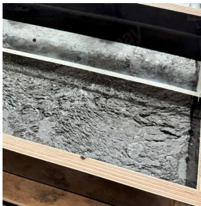
Séchage prématuré de la surface en raison du vent
