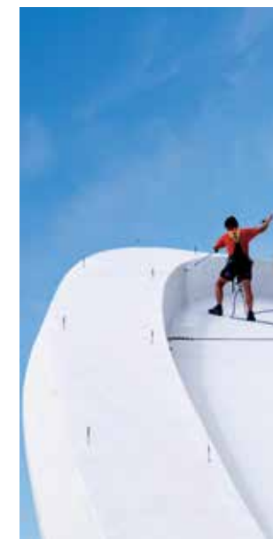
Nouvelles toitures et travaux de réfection de couverture avec les systèmes de membranes Sika® Sarnafil® et Sika® RoofPro® MTC.
