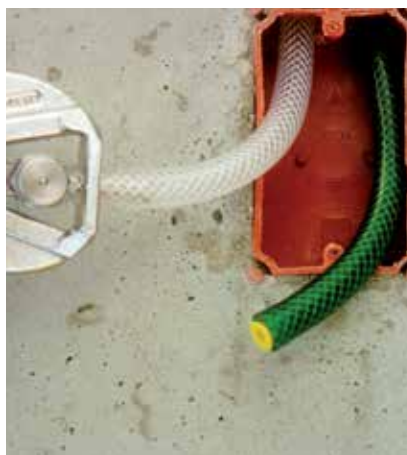
Boite de jonction et sortie de tuyaux sur site
